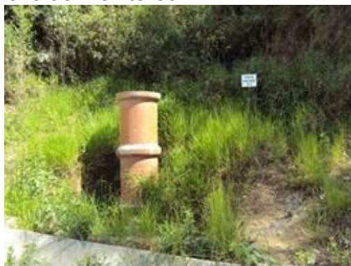
Pozo de Monitoreo N°1
